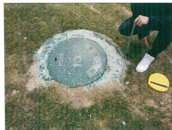
雨水调蓄池检查井
