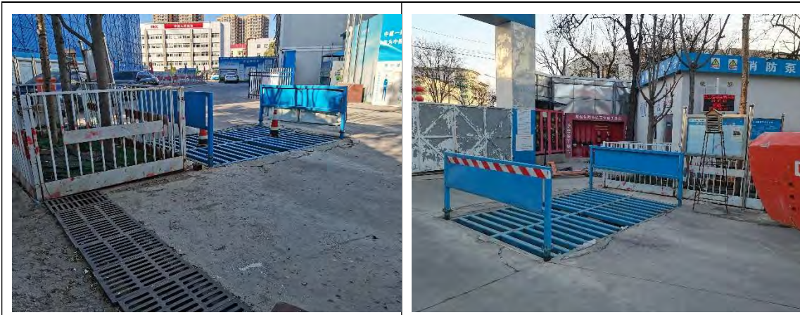
出入口洗车机、沉沙池
