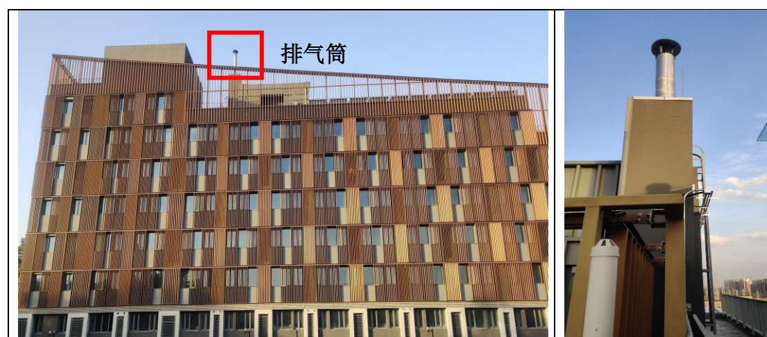
图 3-1 1812-L02 地块锅炉排气筒
