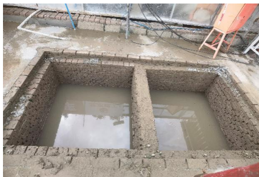
图 2-7 临时沉沙设施 (2022.8)
