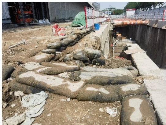
图 3-7 地下出入口阻水土袋 (2023.8.4)
