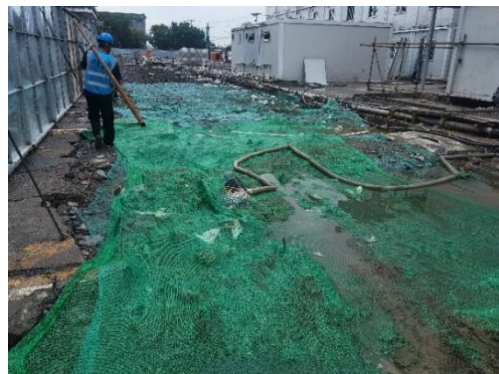
图 3-6 施工生产区积水情况 (2023.8.2)
