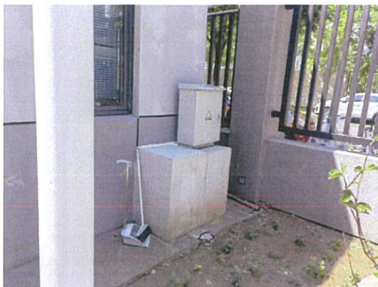
雨水调蓄池配电箱
