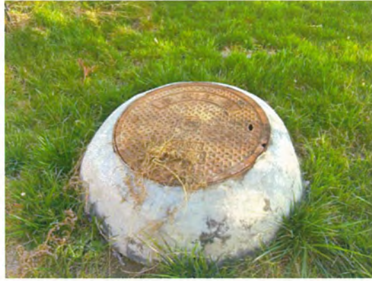
雨水调蓄池检查井
